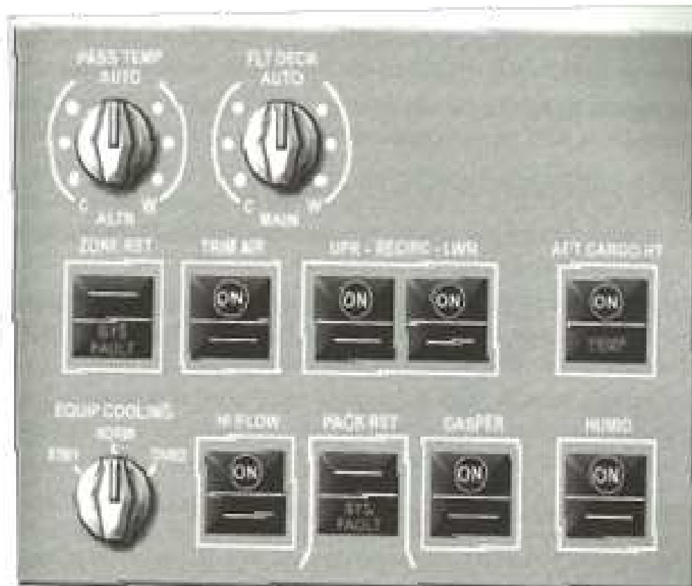
Panel de sistema de aire acondicionado del Boeing 747-400
