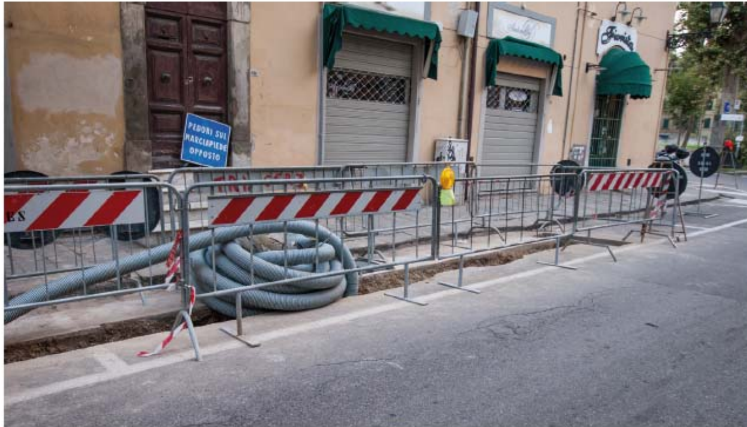
Figura 9.23. Señalización para indicar que hay una zanja.
