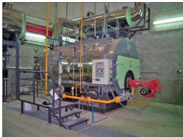
Sala de calderas
