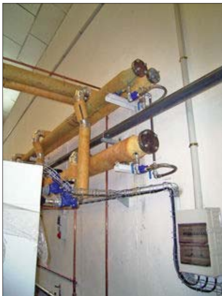
Líneas de vapor a dos presiones con purgador final de línea
