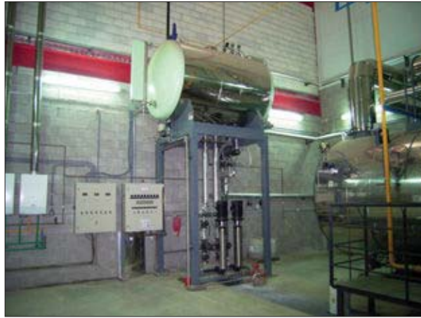
Sistema de recogida de condensados a alta presión (ATTSU)
