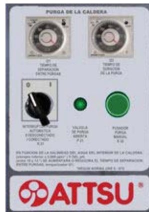
Cuadro de mandos purga automática (ATTSU)
