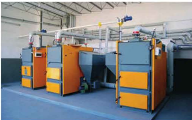
Figura 10.4. Calderas de pellet
