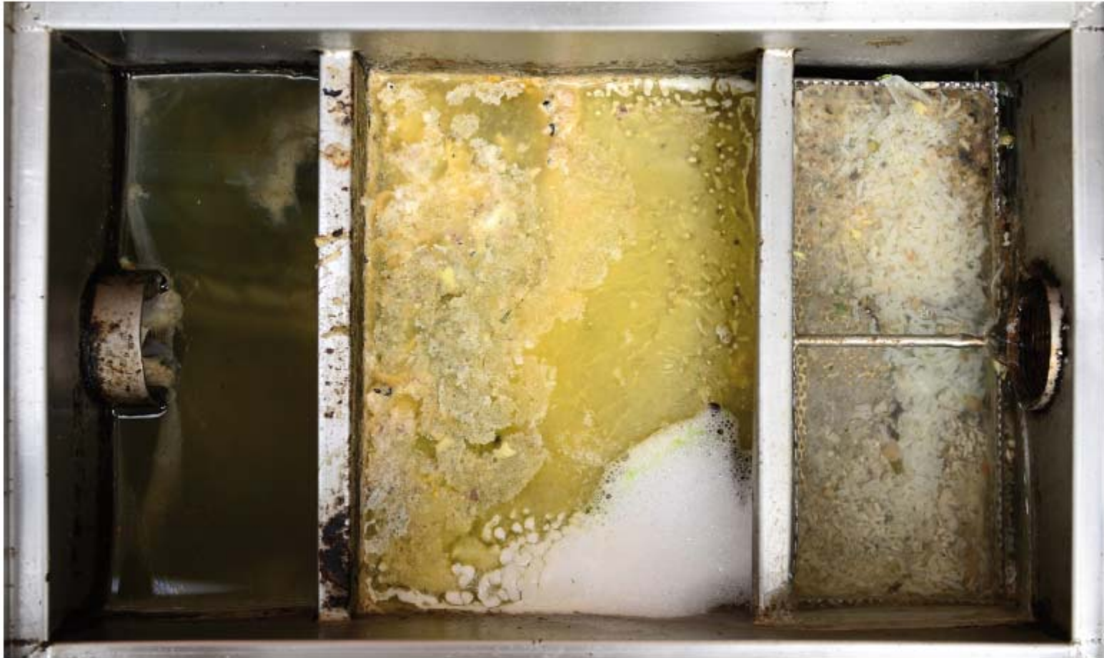
Figura 5.22. Vista superior de un separador de grasas y fangos.
