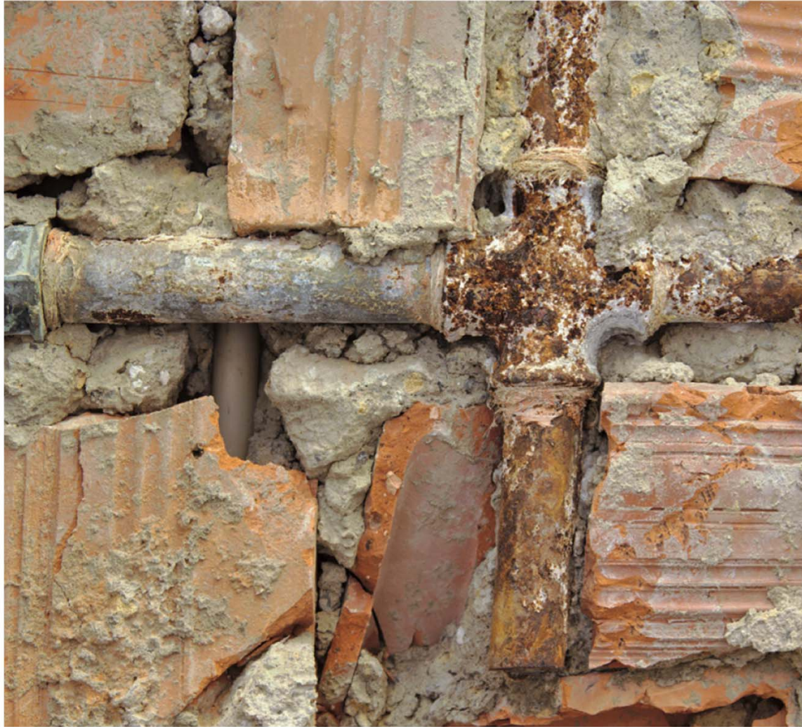
Figura 3.47. Corrosión de tubería de acero galvanizado empotrado directamente en pared sin funda aislante.
