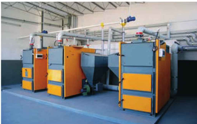
Figura 10.4. Calderas de pellet
